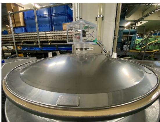
タンク上部に設置した「におい」センサー
