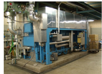
蒸気吸収式冷凍機(千現)
