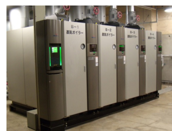
ボイラー設備(千現)
