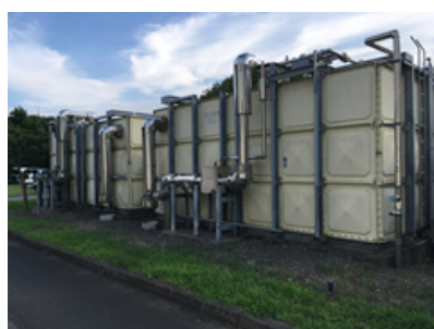
上水供給設備 (干現)
