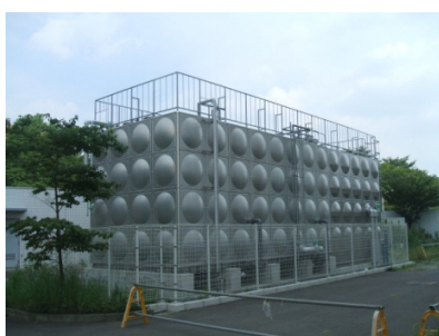
上水供給設備 (並木)
