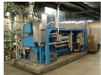
蒸気吸収式冷凍機(千現)
