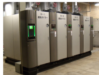
ボイラー設備 (千現)
