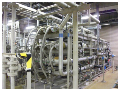
研究廃水処理設備（千現）
