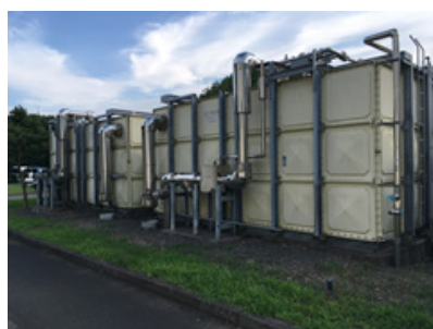
上水供給設備 (千現)
