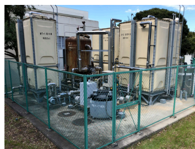
地下水ろ過膜システム (千現)
