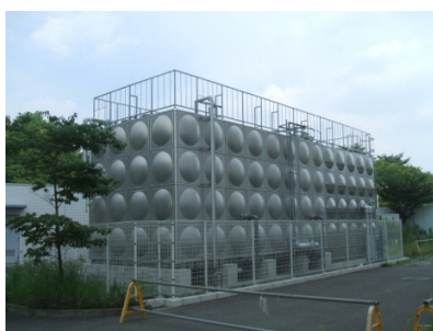
上水供給設備 (並木)
