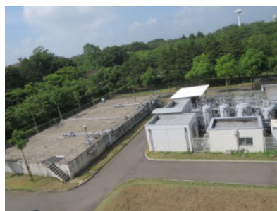
研究廃水処理設備（並木）
