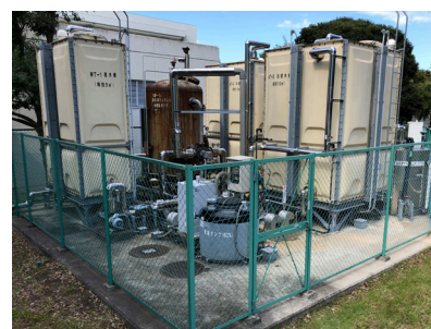
地下水ろ過膜システム（千現）
