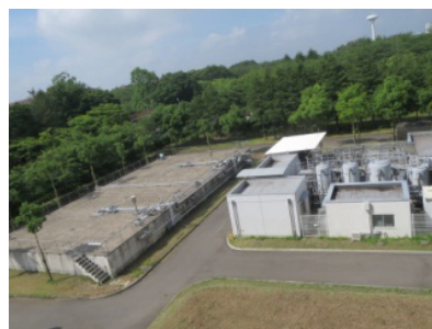
研究廃水処理設備（並木）
