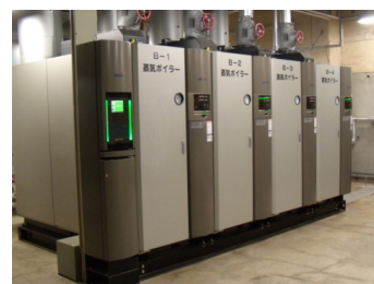
ボイラー設備 (千現)
