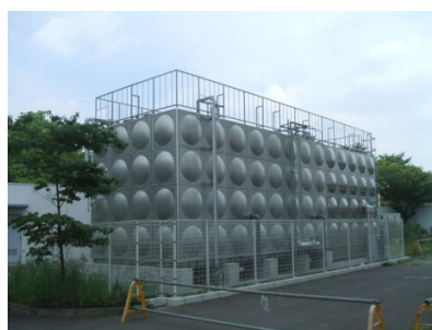
上水供給設備（並木）
