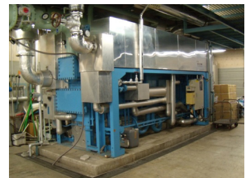
蒸気吸収式冷凍機(千現)
