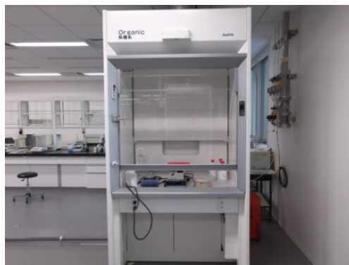
実験室のドラフトチャンバー設置
