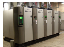
ボイラー設備 (千現)
