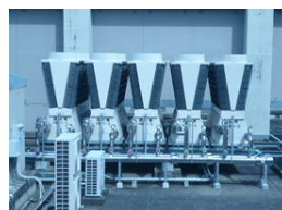
ヒートポンプ式温水機 (桜)
