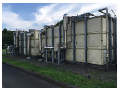
上水供給設備 (干現)
