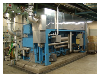
蒸気吸収式冷凍機（千現）
