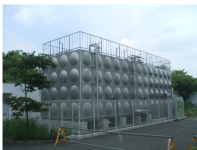
上水供給設備 (並木)
