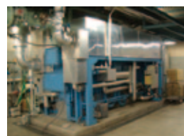
蒸気吸収式冷凍機（千現）
