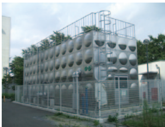
上水供給設備（並木）
