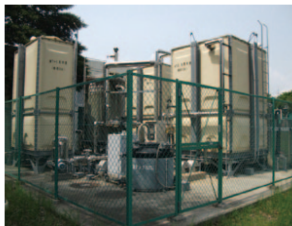
地下水取水設備（千現）
