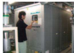
直焚き蒸気吸収式冷温水機(千現)
