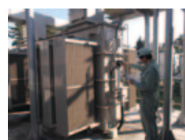
変電設備 (並木)
