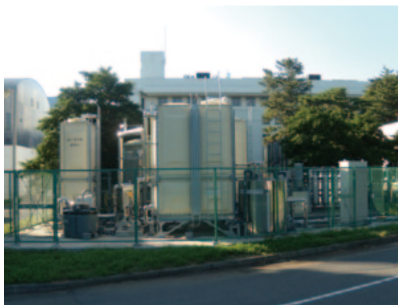
地下水取水設備 (千現)
