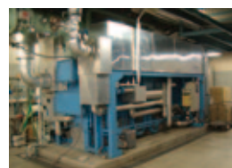
蒸気吸収式冷凍機(千現)
