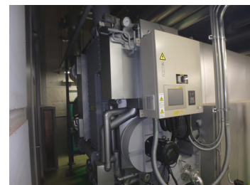
吸収式冷凍機（並木）
