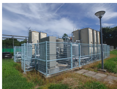
地下水処理装置 (並木)
