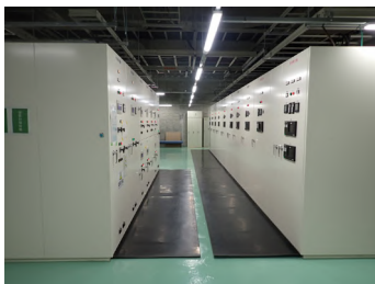
本館電気室（干現）
