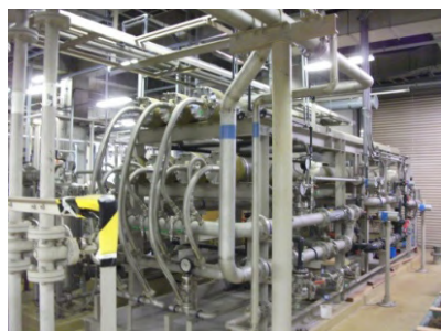
研究廃水処理設備 (干現)
