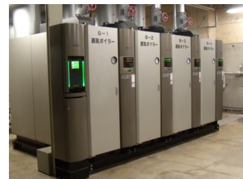
ボイラー設備 (千現)
