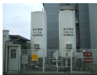
液化窒素貯槽(並木)
