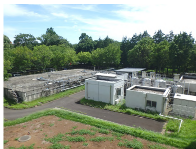
実験廃水処理施設 (並木)
