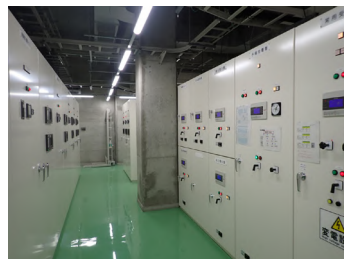
実験棟電気室（干現）
