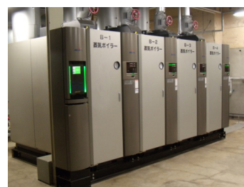
ボイラー設備 (千現)
