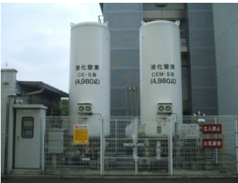
液化窒素貯槽 (並木)
