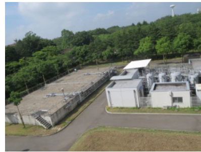
研究廃水処理設備（並木）
