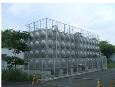
上水供給設備 (並木)
