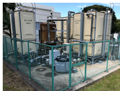
地下水ろ過膜システム (千現)
