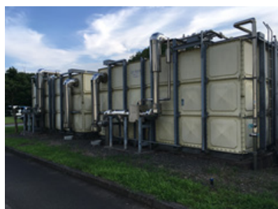
上水供給設備 (千現)
