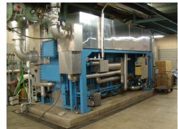
蒸気吸収式冷凍機（千現）
