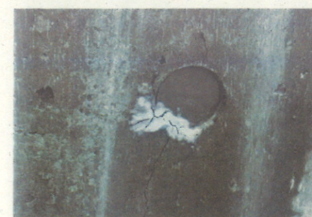
自己治癒コンクリート「Basilisk」の修復前
