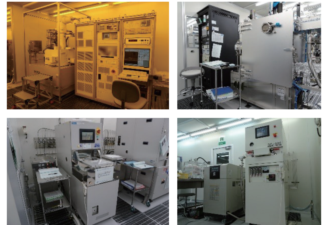
図1: 本研究で使用した主な共用設備
