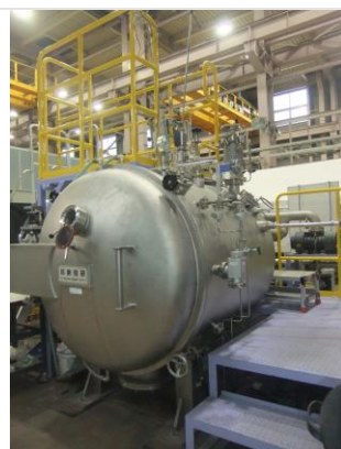
30kg 高周波誘導真空溶解炉
