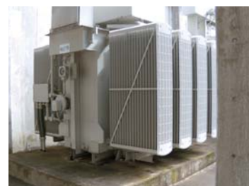
変電設備(千現)
