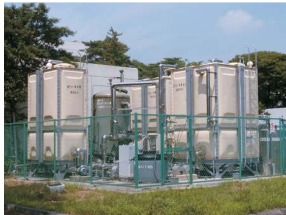
地下水取水設備 (千現)
