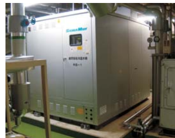
直焚き蒸気吸収式冷温水機 (千現)
