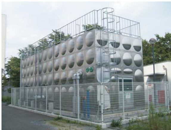
上水供給設備 (並木)
