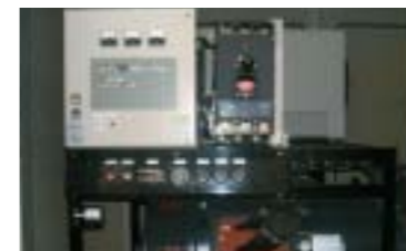
自家発電機 (並木)
