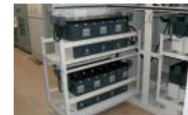
蓄電池設備 (千現)
