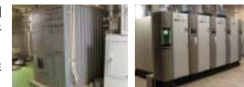
直焚き蒸気吸収式冷温水機(千現) ボイラー設備(千現)
