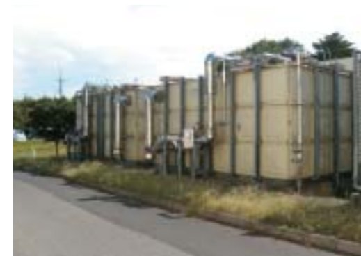
上水供給設備(千現)
