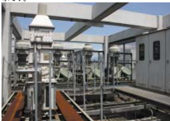
千現地区ファインプロセス実験棟排ガス洗浄装置
