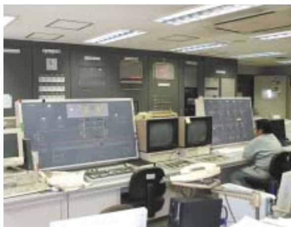
千現地区中央監視室・施設運転管理
