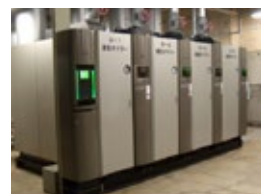
ボイラー設備 (千現)
