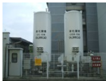
液化窒素貯槽 (並木)
