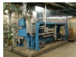
蒸気吸収式冷凍機 (千現)
