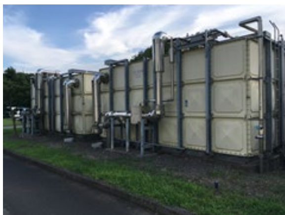
上水供給設備(千現)
