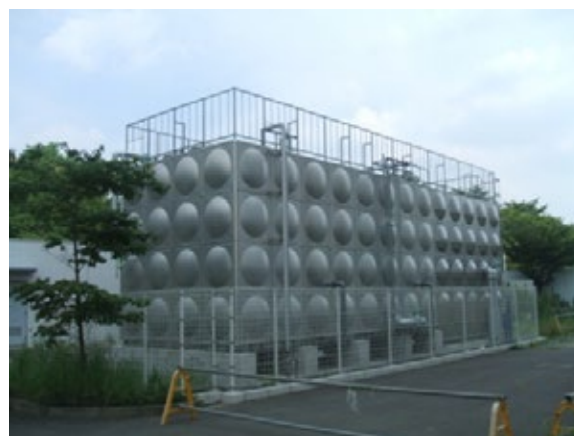
上水供給設備(並木)
