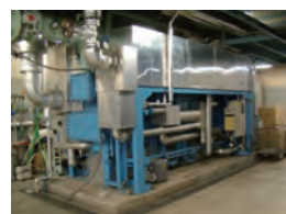
蒸気吸収式冷凍機（千現）
