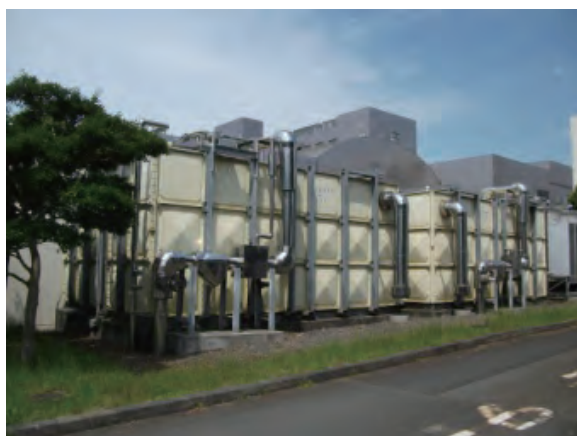
上水供給設備(千現)
