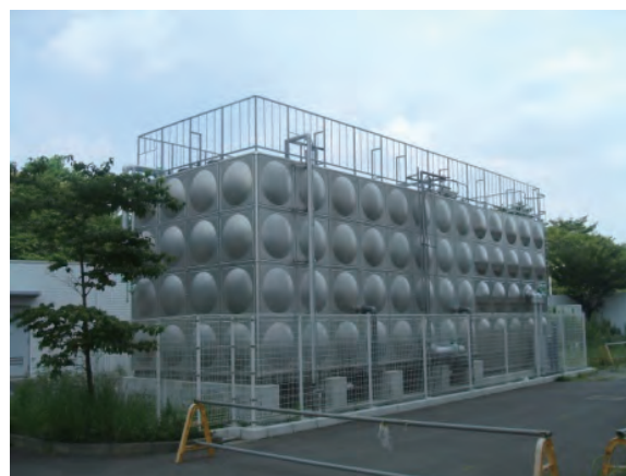
上水供給設備(並木)
