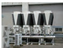
ヒートポンプ式温水機（桜）
