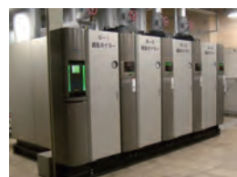
ボイラー設備（千現）
