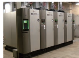
ボイラー設備（千現）
