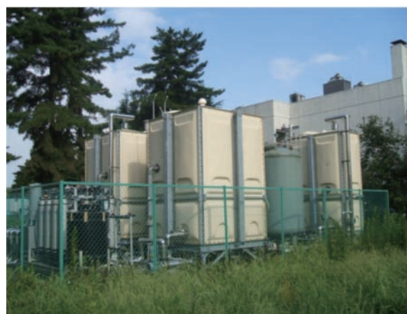
地下水取水設備 (並木)
