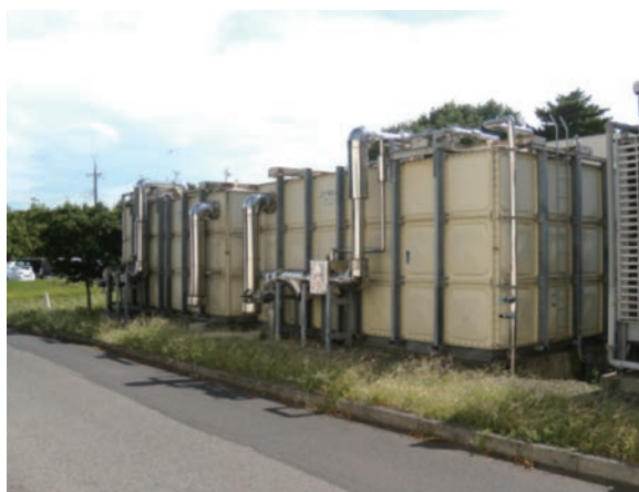
上水供給設備 (千現)
