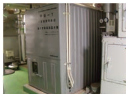
直焚き蒸気吸収式冷水機（千現）
