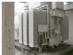
変電設備（千現）
