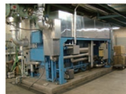
蒸気吸収式冷凍機（千現）
