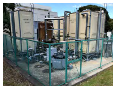
地下水ろ過膜システム (千現)
