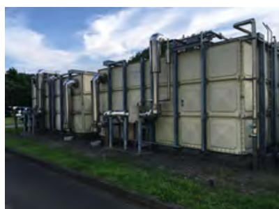
上水供給設備 (千現)
