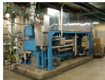
蒸気吸収式冷凍機(千現)
