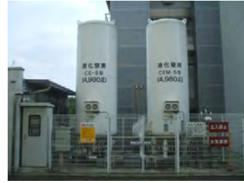
液化窒素貯槽 (並木)
