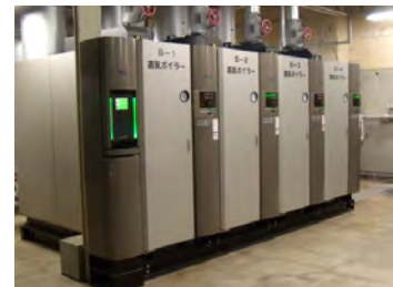
ボイラー設備 (千現)
