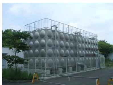
上水供給設備 (並木)
