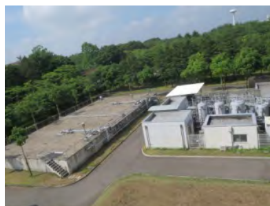
研究廃水処理設備（並木）
